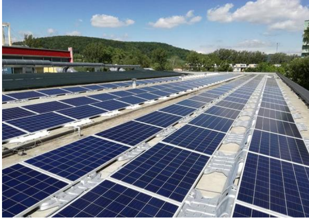
Obr – príklad strešnej inštalácie FVE
